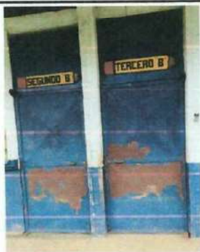
Foto 3: Se puede observar el deterioro de las puertas .
