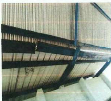
Foto 5: Se puede observar el deterioro de las costaneras portantes .
