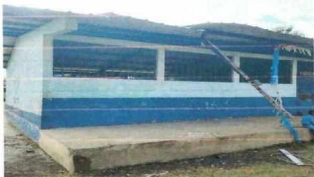
Foto1: Se puede observar las laminas portantes en mal estado del modulo 1.
